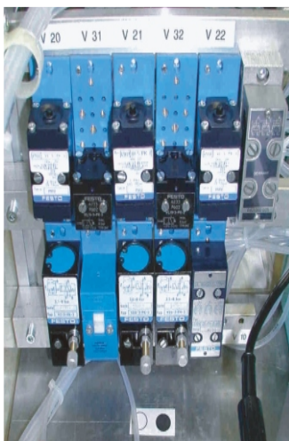
< Steuertableau der pneumatischen Steuerung
